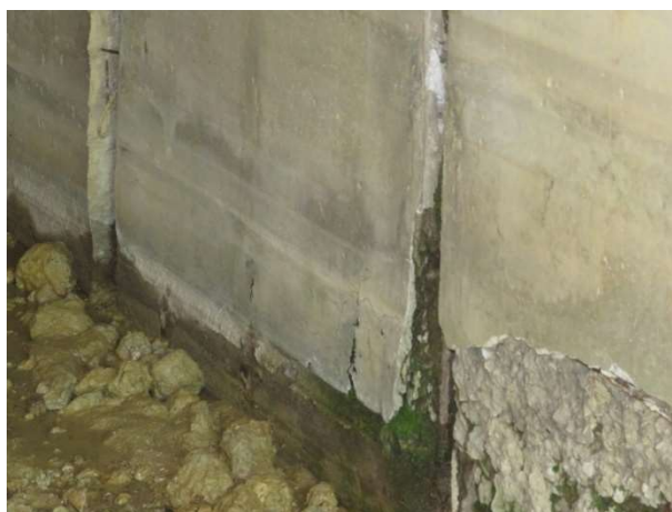
Рисунок 4 – Руйнування в нижній частині секцій водопропускної труби Figure 4 – Damage in the lower part of the culvert sections
