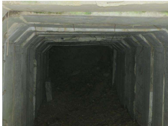
Рисунок 5 – Деформації зміщень секцій водопропускної труби Figure 5 – Displacement deformations of the culvert sections
